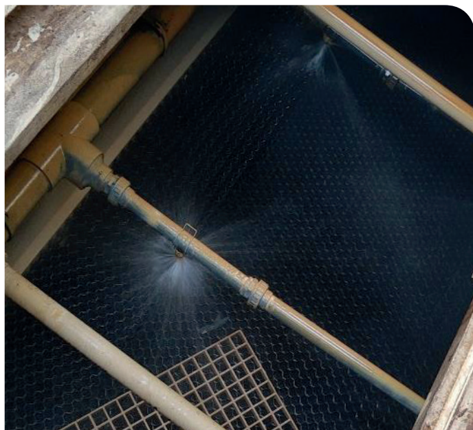
Chemische luchtwasser bij Biogas Bree
